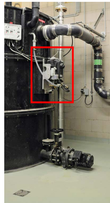
Čištění odlučovacího systému
